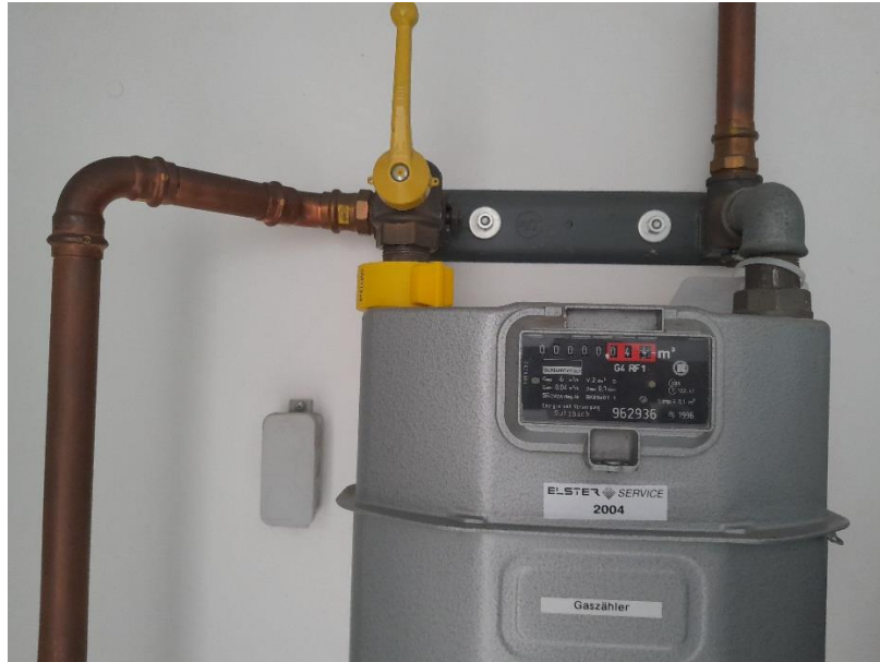
Abb. 10 Messeinrichtungsanschlussplatte in der Gas-Hausinstallation
