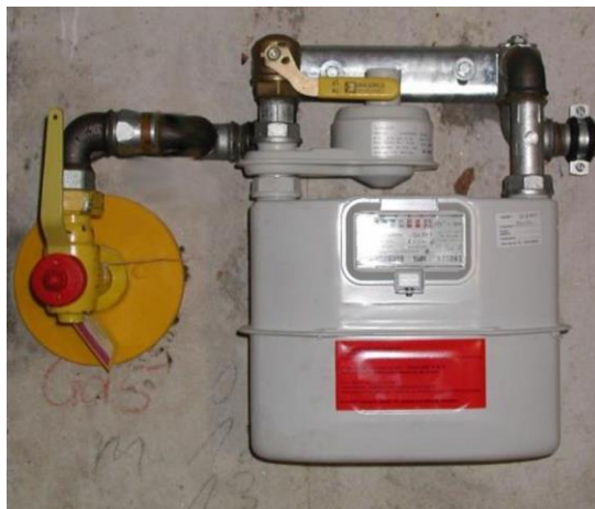
Abb. 9 Beispiel eines Einzelanschlusses mit Gasdruckregler und Gas-Messeinrichtung
