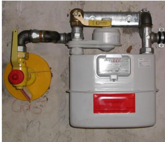
Abb. 4 Beispiel eines Einzelanschlusses mit Gasdruckregler und Gas-Messeinrichtung
